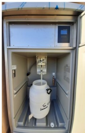
Le préleveur réfrigéré sortie station renouvelé le 20/05/2021.
