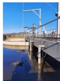
Agitateur du bassin d'aération
