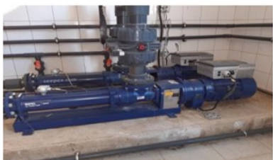
Pompe à boues de secours
