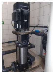
Surpresseur de lavage du filtre bande
