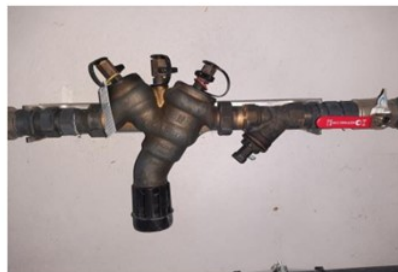
Afin de pallier les éventuels risques de contamination du réseau d'eau potable, un disconnecteur a été installé sur la conduite AEP de la STEP.
