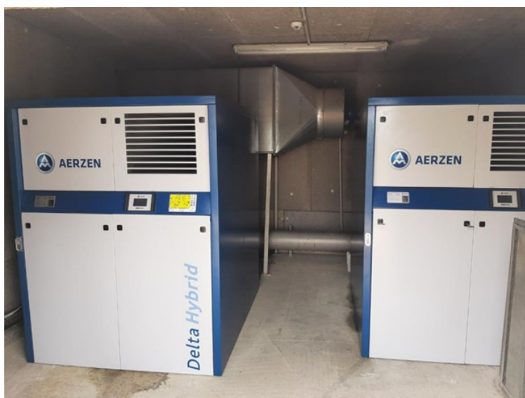
Nouveaux surpresseurs installés en Novembre 2020
